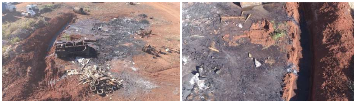
Figura 1 e 2 – Emulsão asfáltica derramada ao lado da valeta aberta. Fonte: registro feito pela equipe de fiscalização.
